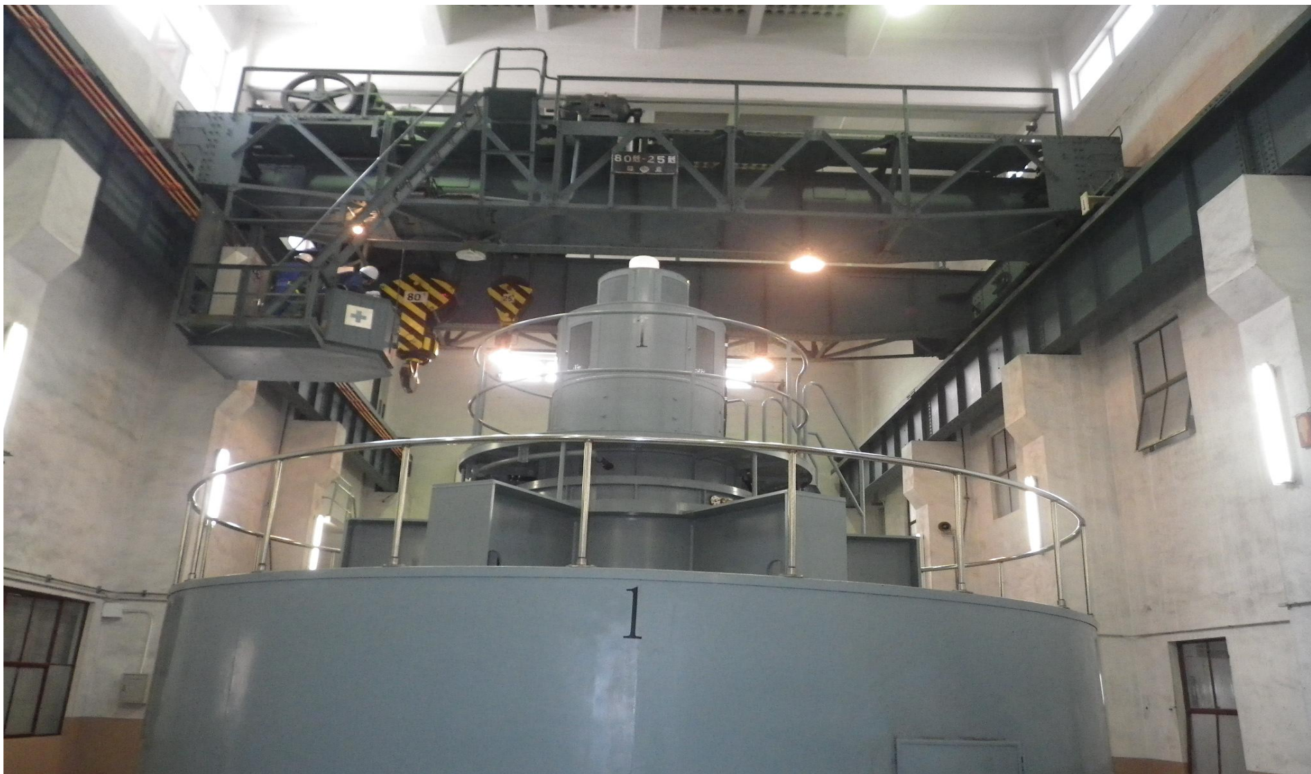
天井クレーン稼働時様子
