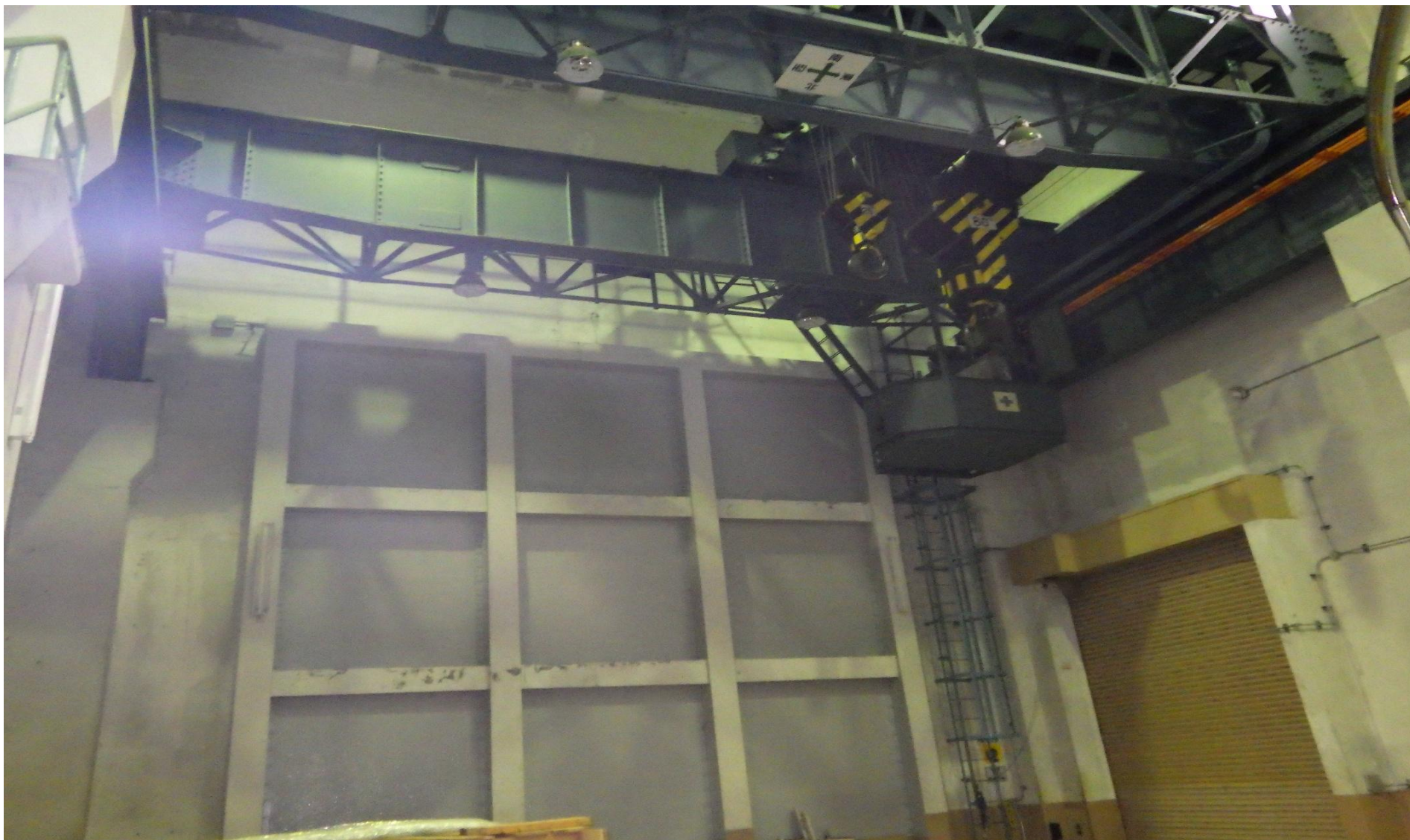
天井クレーン様子
