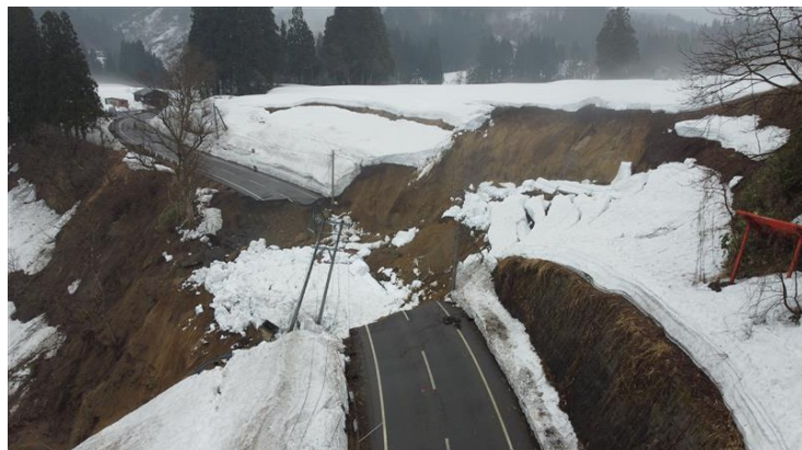
道路崩落状況（令和7年3月28日）
