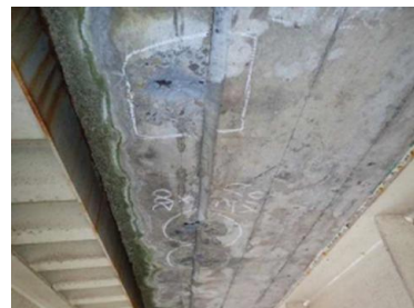
床板鉄筋の露出状況 旭橋（小千谷市元町）
