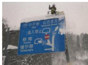
雪庇落とし状況 主要地方道柏崎高浜堀之内線(長岡市山古志)
