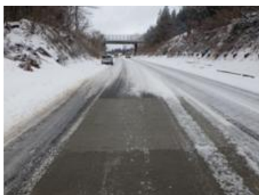
地中熱を利用したヒートパイプによる融雪状況 一般国道117号(小千谷市塩殿)
