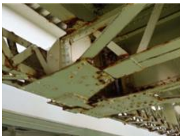
桁材の損傷状況 長生橋（長岡市大島町）
