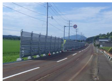
吹き止め柵設置状況 一般県道寺泊西山線(長岡市上桐)
