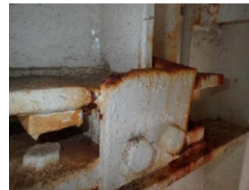
支承部の損傷状況 旭橋（小千谷市元町）
