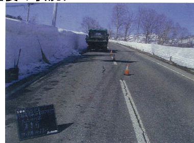
<被災直後の状況>
