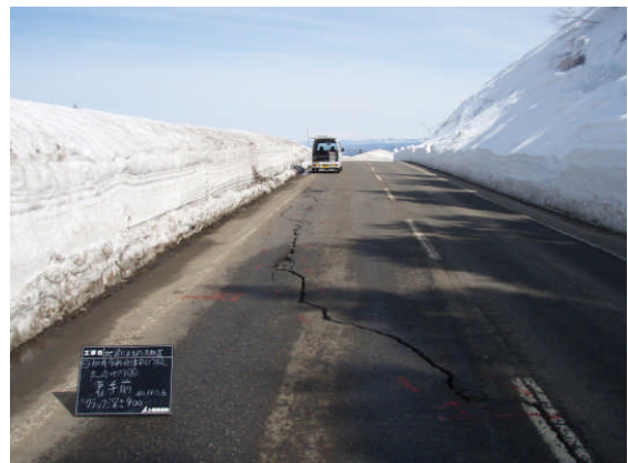
<被災直後の状況>
