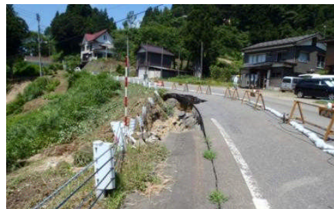
<被災直後の状況>
