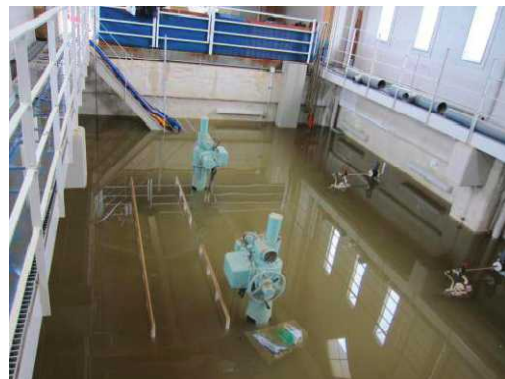
浸水した機場 西野揚水機場
