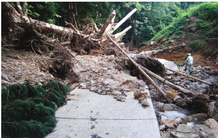
【斜面の崩落により寸断された山腹農道】 三条市北五百川
