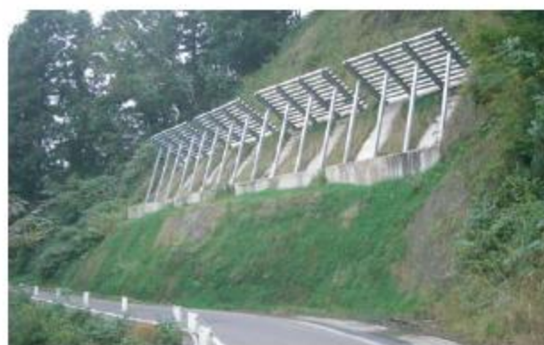
斜面に設置された雪崩予防柵
