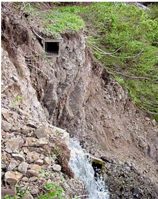
余震により崩壊した山腹水路 (魚沼市〈旧守門〉)
