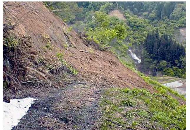
融雪の影響により山側斜面が崩落した農道 (十日町市)
