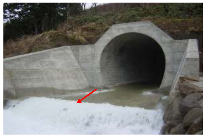
転流翌日の仮排水路吐口
