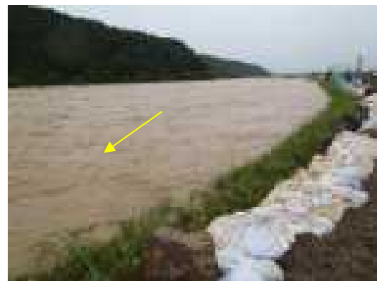
平成 23 年 7 月洪水 五十嵐川の水防活動による仮堤防 (三条市島潟)
