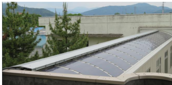
妙高クリーンセンターに設置された カルコパイライト太陽電池
