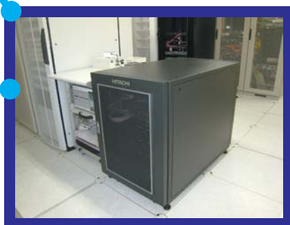
県庁危機管理センター（県庁監視局）
