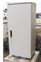
自動起動型 発電機
