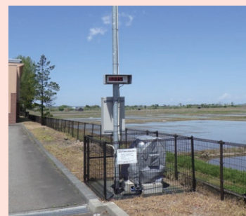
緊急時局の監視
