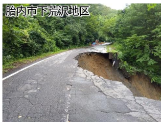
欠壊した道路
