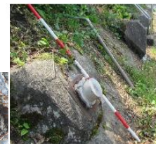
H30 アンカー鋼材の発錆等 老朽化に伴う機能低下 を確認 改築に着手
