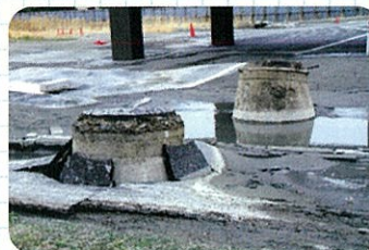
地中から突き出たマンホール
