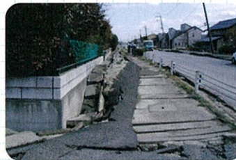
液状化で波打つ歩道
