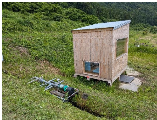
小水力発電施設
