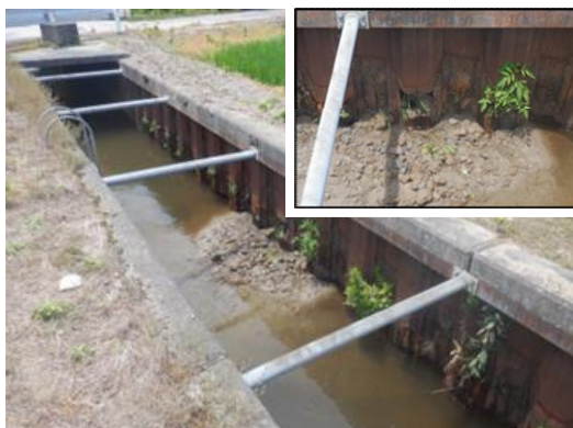
< 鋼矢板の腐食が進む排水路 >
