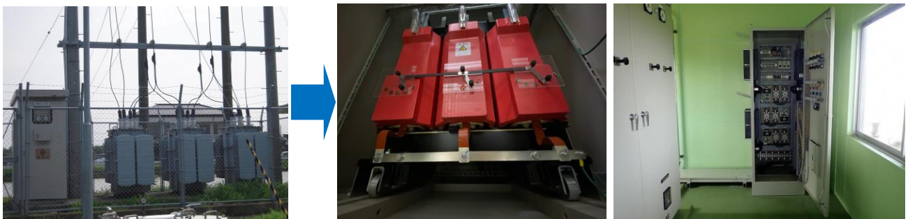
<整備前（従来の変圧器）>
