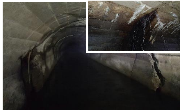
< コンクリートの劣化により漏水が進む水路トンネル >
