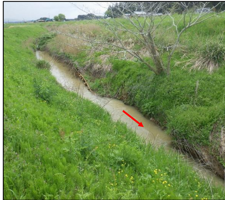
未改修区間 (柵杭、柵板転倒)
