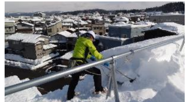
命綱固定アンカーを使用した雪下ろし
