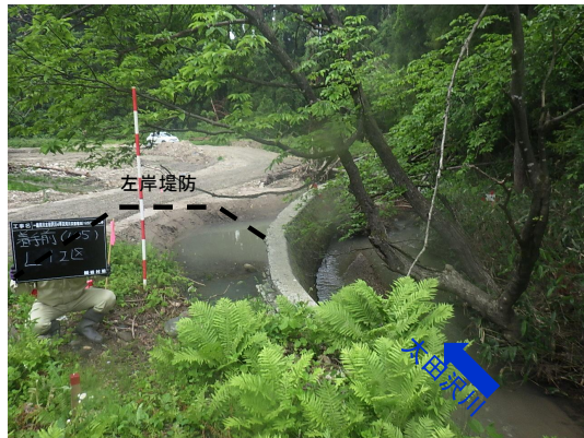
太田沢川破堤箇所(写真②)
