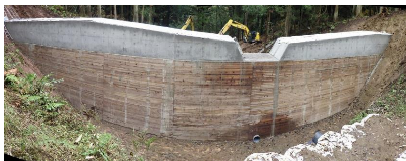
公共土木工事で施工された残存型枠
