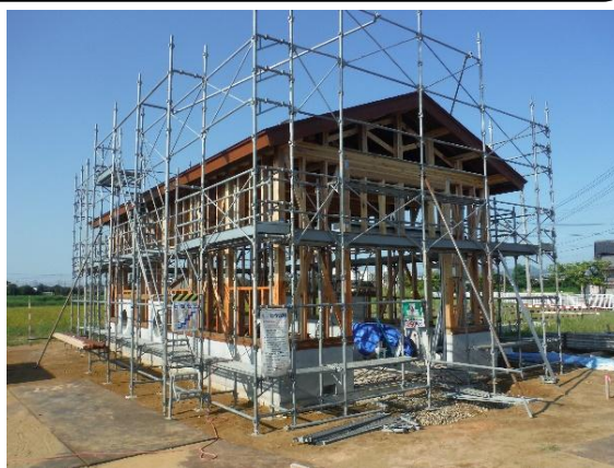
県産木材を構造部に利用した揚水機場上屋
