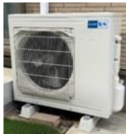
エアコンディショナーの室外ユニット 電気温水機器のヒートポンプ
