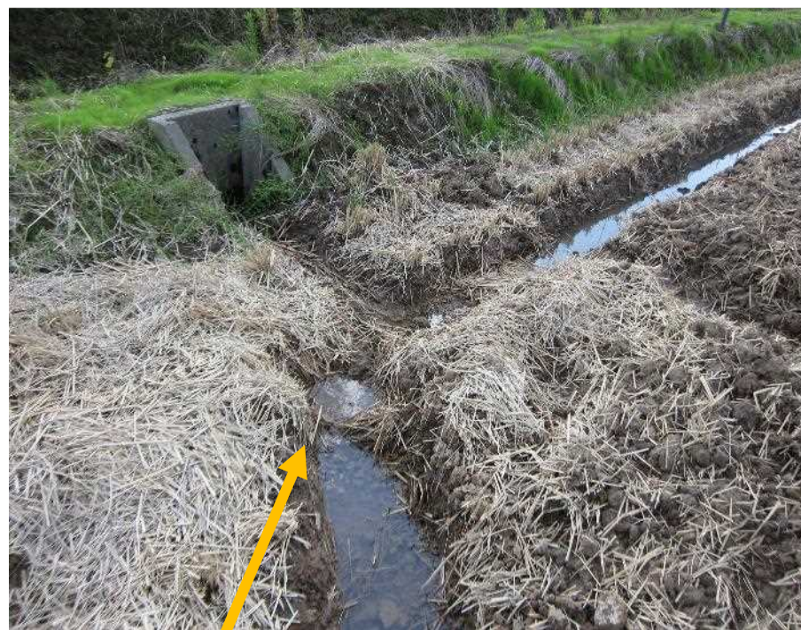
排水溝の崩れ
