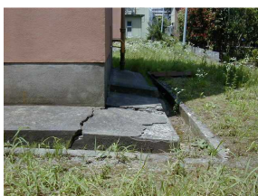
高田地区公民館の建物周辺の破損
