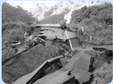
道路の被害(旧堀之内町)
