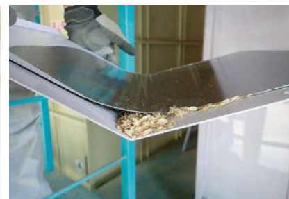
昇降機上部のふた
