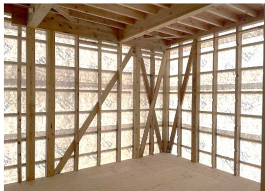
県産木材を構造部に利用した住宅 (構造部の見学会を開催)
