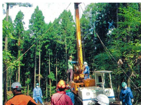
タワーヤード
