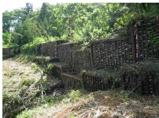
<築造後の時間経過により老朽化が進行>
