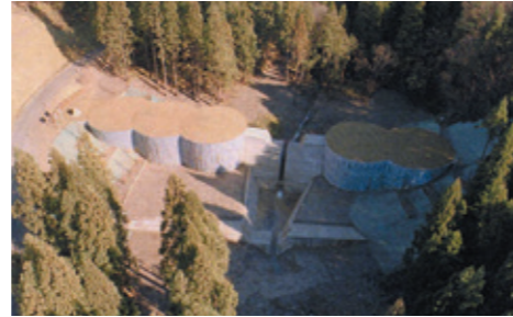
沢ノ入沢砂防えん堤 鋼製セルとスリット(胎内市夏井) 写真提供/国土交通省 北陸地方整備局 飯豊山系砂防事務所
