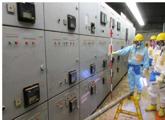
非常用高圧電源盤
