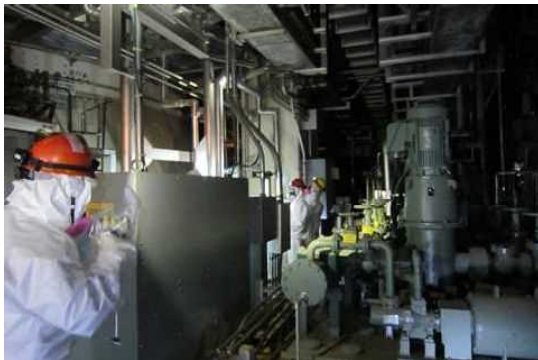
2階の損傷は軽微
