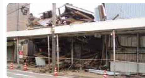
激しい揺れで倒壊した建物
