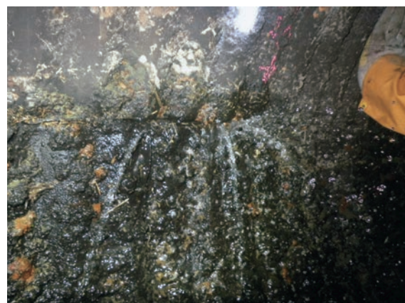
(写真2) コルゲート管漏水状況
