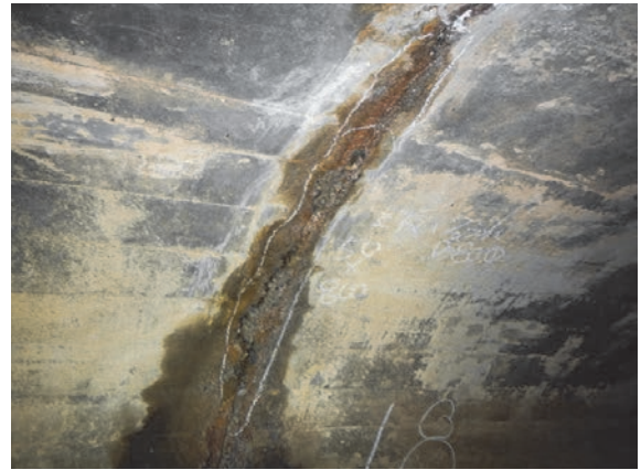
写真3 目地の劣化状況
