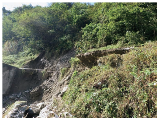
写真-3 管理道路路肩・導水路基礎の流出
