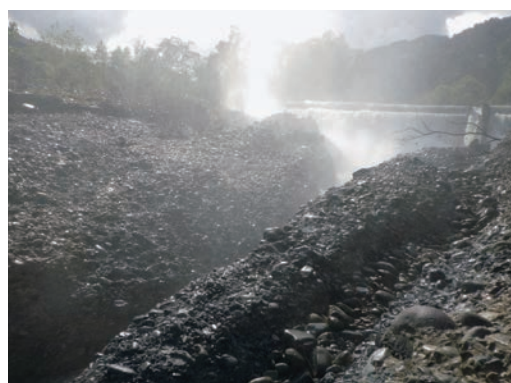
写真-5 下流河床の洗掘-2
