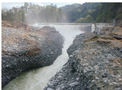
写真-4 下流河床の洗掘-1
