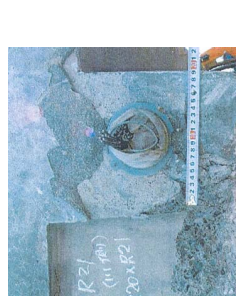
R20～R21のPC鋼材破断状況 (R21のR20側・信濃川側)
