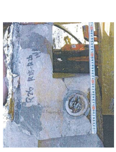
R25～R26のPC鋼材破断状況 (R26のR25側・信濃川側)
