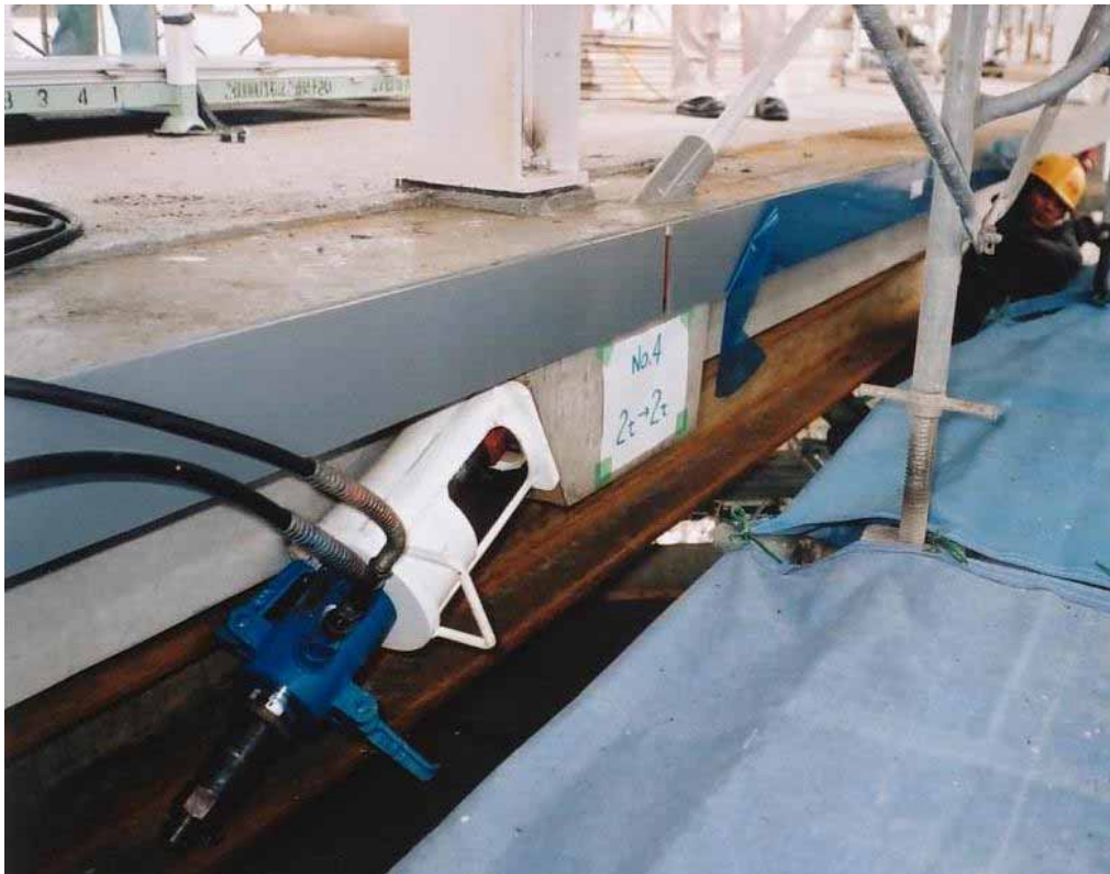
写真 センターホールジャッキとチェアー（清水JV工区）
