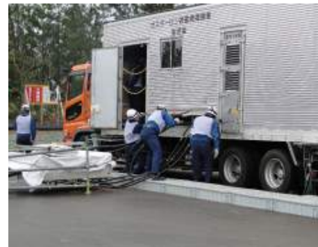
GTGによる電源供給訓練風景
