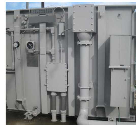
3号高起動変圧器 中性点接地装置
