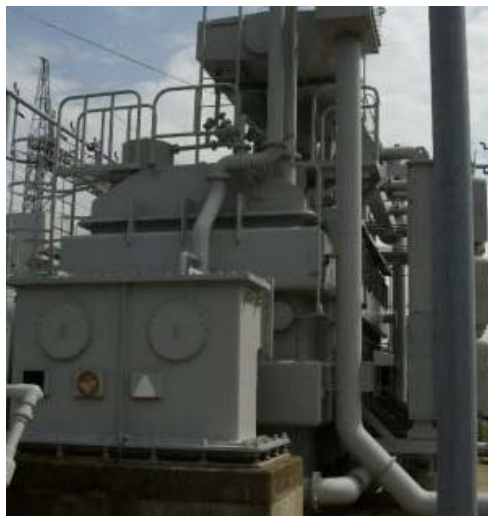
3号高起動変圧器
