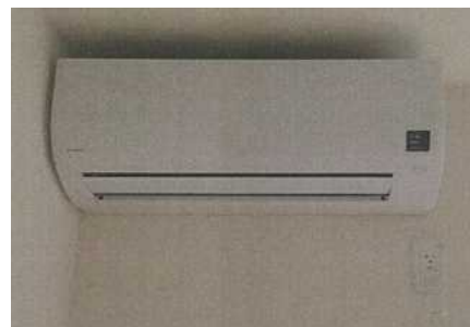
ファンコイルユニット(エアコン型)
