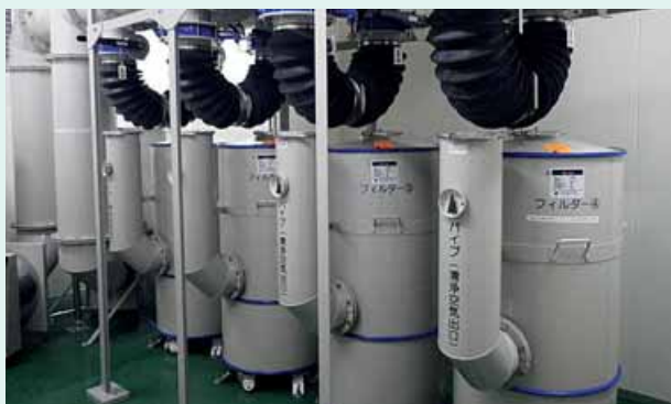
放射性物質除去フィルター設備
