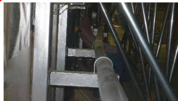
変形したトレンチ内の配管
