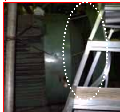
上部カバーの変形
